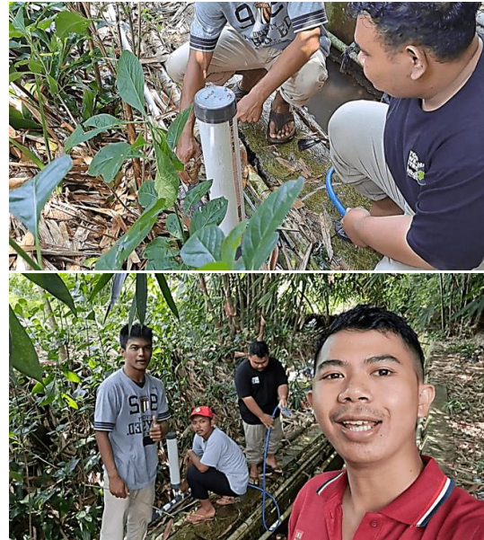
Gambar 5. instalasi pompa hidram
