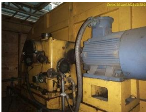
Gambar 1. Turbin Uap Pada PLTU XYZ
